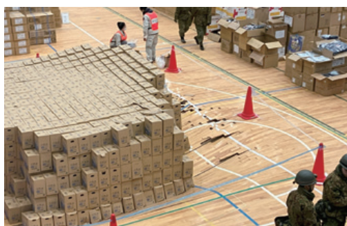
集積拠点にて物資の重さに耐えられず床が抜ける
