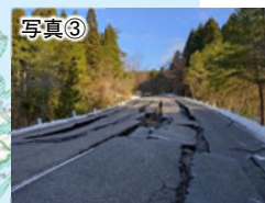
被災状況(迂回路により普通車通行可)
