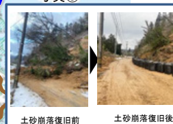
県道285号崩落箇所緊急復旧
